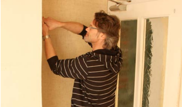
Making_of_19: Renovierungsarbeiten – ein auffälliges Gebäude wird für den Dreh zur Polizeiinspektion, Regisseur Markus Kleinhaus legt selbst Hand an
